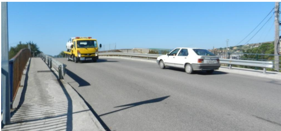
Fotografía 9. Puente del Paseo Fernández Vallejo sobre el ferrocarril de ADIF de ancho ibérico
